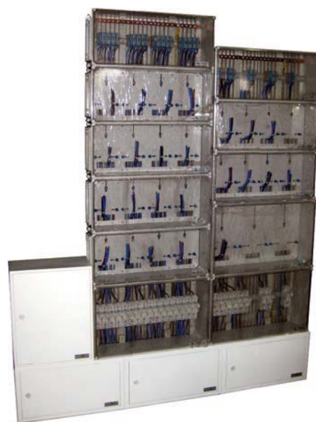
Exemplo de Bateria de contadores com Caixa de Corte Geral e Caixa de Barramento com o mesmo tipo de construção dos Quadros de Coluna.
